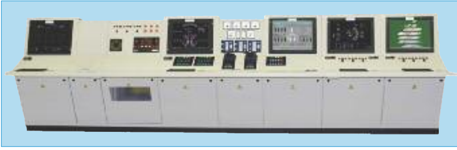
Yanda MilGem korvetleri için üretilen 5 iş istasyonundan oluşan ve geminin elektrik, ana tahrik ve hasar kontrol fonksiyonlarına kumanda edebilen MilGem Makina Kontrol Konsolu, ortada SMART-S Mk2 radarı ve altta G-Sınıfı fırkateynlere entegre edilen GENESIS SYS'ne ait Yaltes ürünü operatör konsolları görülüyor [Fotoğraflar: M. DEMİRKOL/S&H ve Thales].
